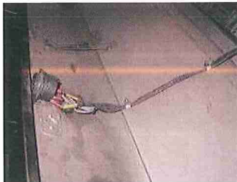
Foto 14: Cableado sonería y led.
