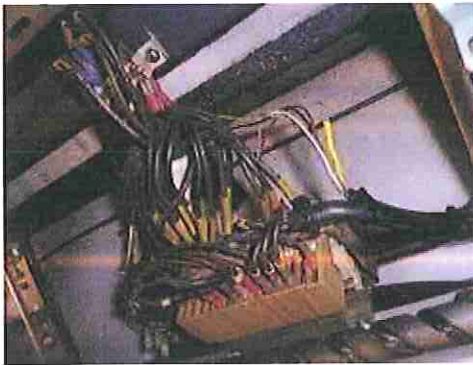
Foto 17: Cables a conectar.
