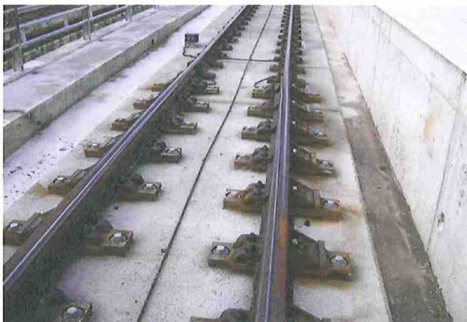
Aparato de dilatación de EuskoTren en Orio
