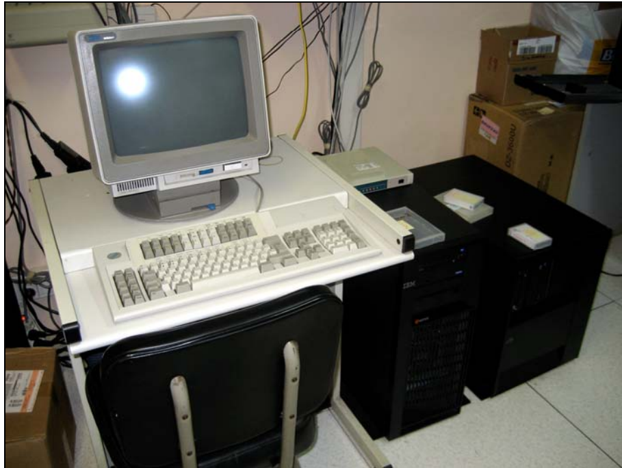
Ilustración: Servidores Centrales TCSA.
