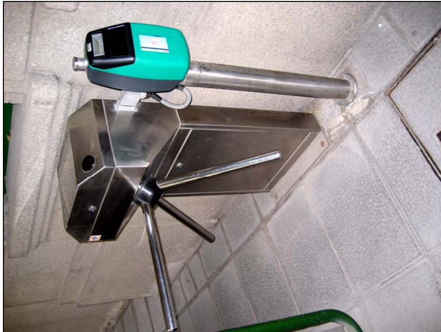
Ilustración: Canceladora y torno de acceso a los Ascensores del Puente de La Salve.
