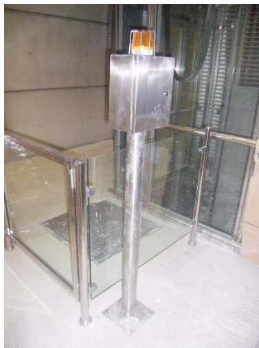
Poste y caja para teléfono selectivo cabecera de andén
