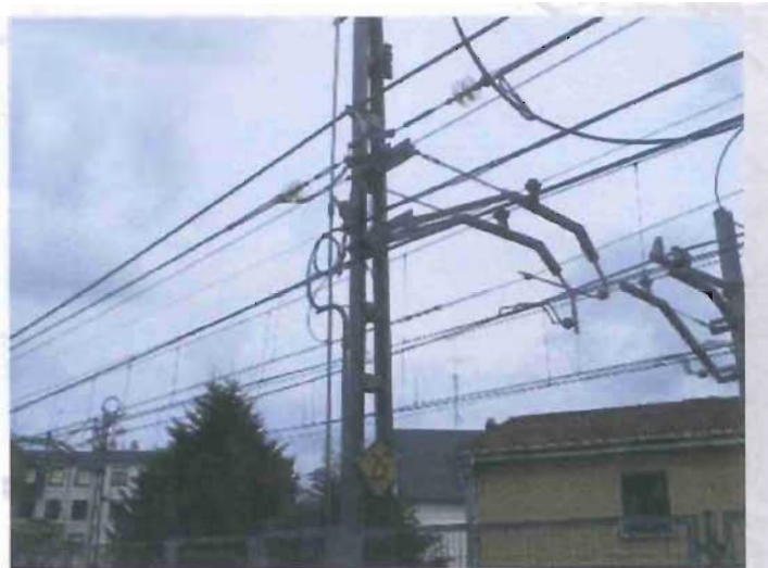
Poste tipo con dificultad de acceso a cabeza de poste
