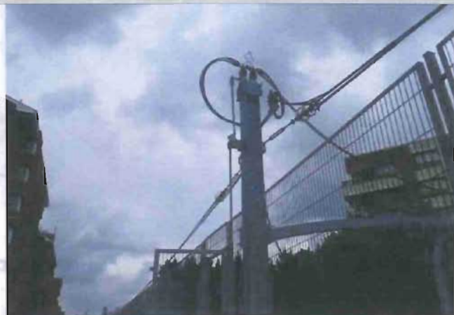
Poste doble T con dificultad de acceso
